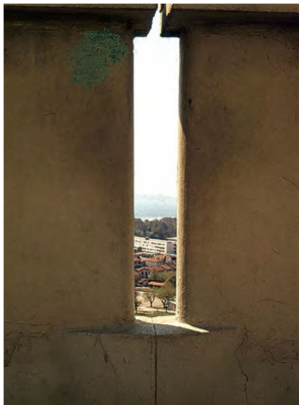
Il. 98. Szczelina w obramowaniu Dachu tarasu (mniejsza od głowy dziecka), aby dzieci mogły bezpiecznie patrzeć na otoczenie, nie próbując wdrapywać się na obramowanie
